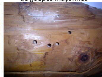
Dégradation de guêpes maçonnès
